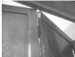
Foto 2. Condición física de puertas sala de usos múltiples rota. Fuente: Salas (2006)
