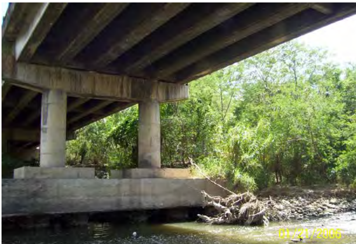
Pilares que sostienen la estructura del Puente Internacional Francisco de Paula Santander
